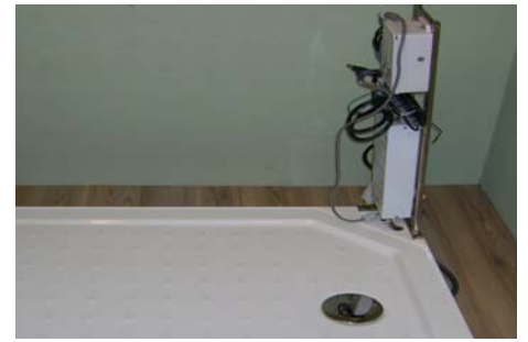
Instalovat generátor install the generator
